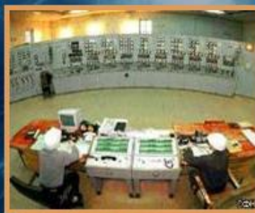
Центр управления АЭС
